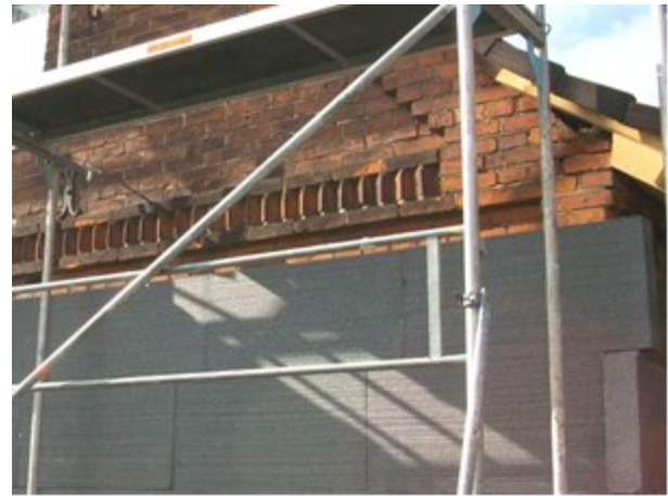
Abb. 31 Negativbeispiel: Außendämmung verdeckt historische Bausubstanz
