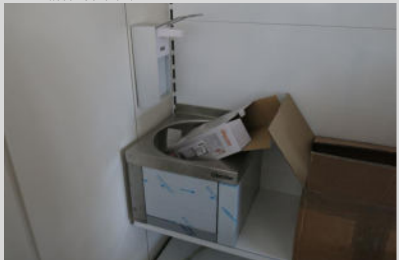
Waschbecken im Kassenbereich
